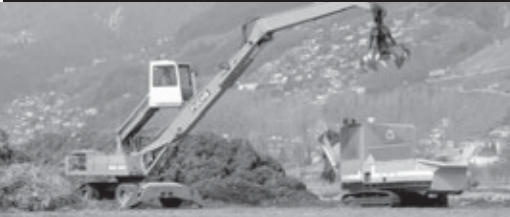
Impianto pilota di compostaggio della Compodino SA di Gordola / Canton Ticino CH.
